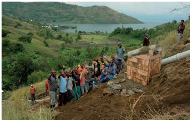
Abb.: Gemeinsam mit den lokalen Arbeitern werden die Fundamente für das Fallrohr betoniert.
